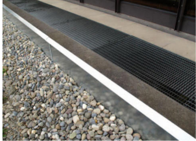
Abb. 13 Absperrblech gegenüber Gefahrenbereich
